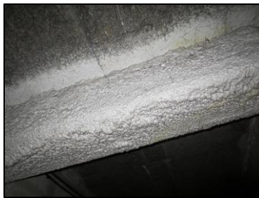
Photo N° 928 AMIANTE CIMENT -- COULOIRS DE CAVES
